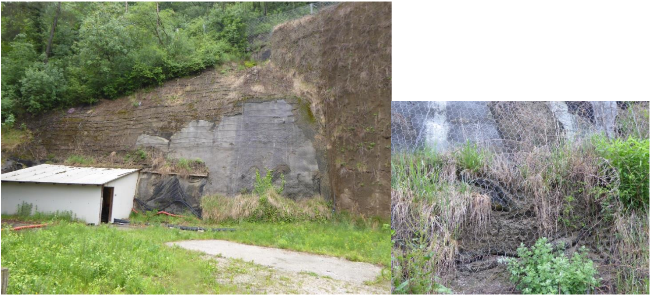
Figura 10: scivolamento della rete tridimensionale di contenimento; a destra particolare
