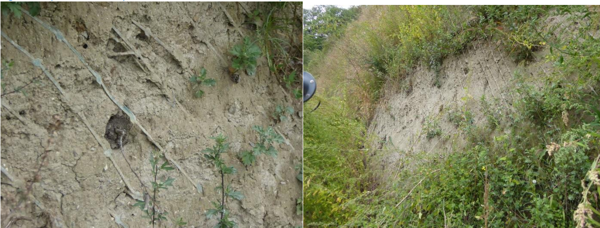
Figura 24: particolare del portale di Aica settembre 2017 – are con piantine non attecchite nell'area che ha sofferto di carenza idrica
