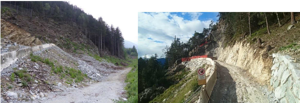
Figura 5: scarpate in riporto in materiale grossolano e roccia esposta
