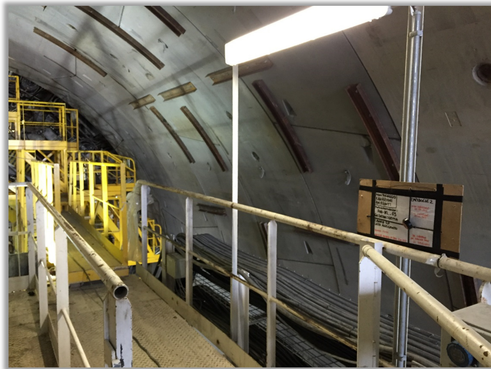
Dosimetro installato all'interno della GN Caltanissetta - canna dx durante lo scavo meccanizzato della TBM
