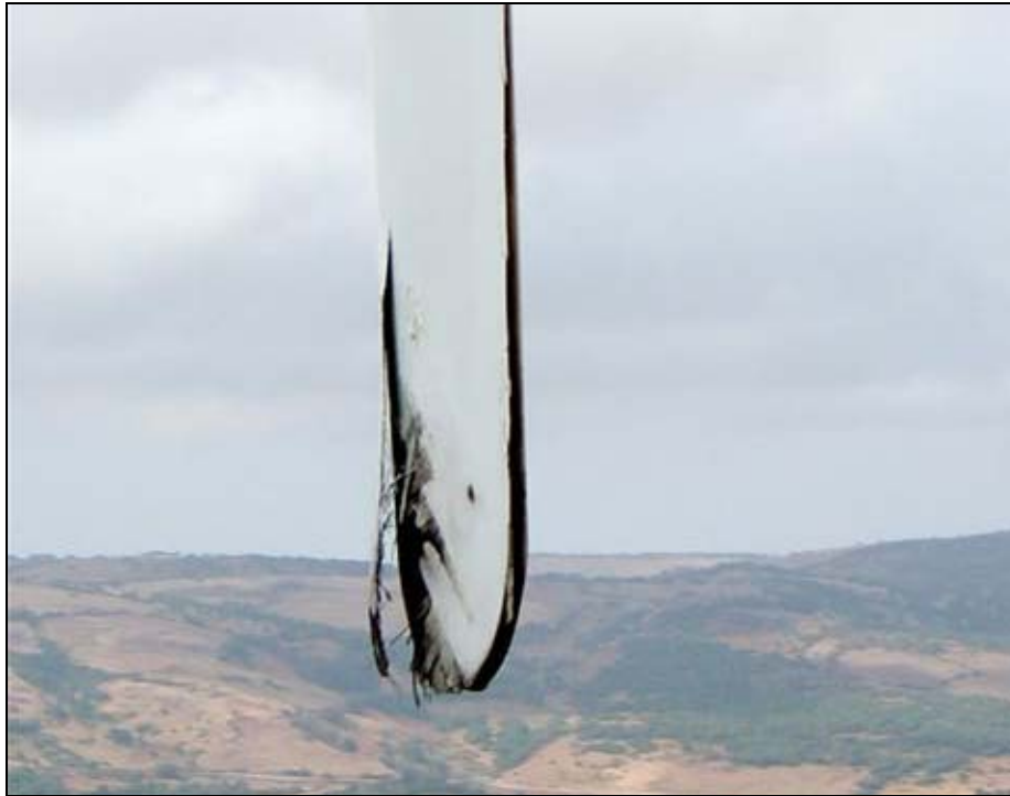
Figura 3: Estremità di pala danneggiata da fulminazione atmosferica.
