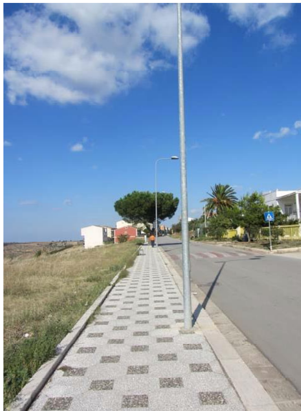
Foto 1 – palo tipo della pubblica illuminazione da sostituire lungo Viale Matteotti
