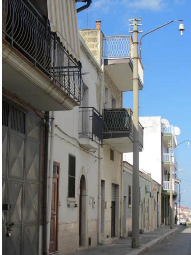
Fig. 6 – palo tipo da sostituire lungo Viale Elena-Via XXIV Maggio
