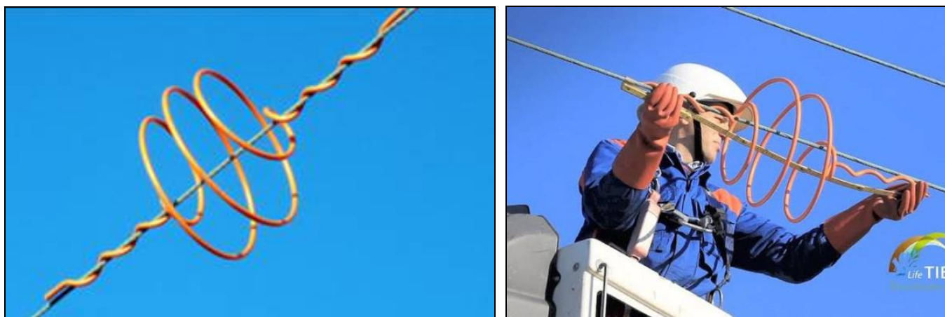
Figura 2-3. Esempio di spirale applicata a cavi elettrici per la riduzione del rischio di collisione (Fonte Web).
