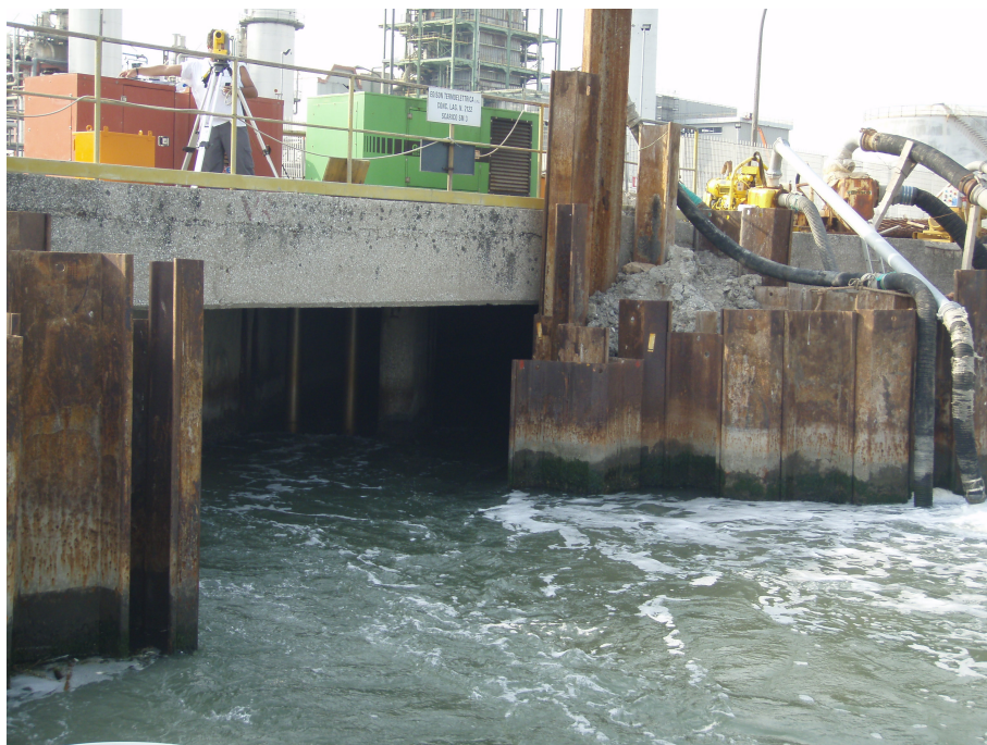
Foto 2 – Condotto di scarico dell'acqua di raffreddamento
