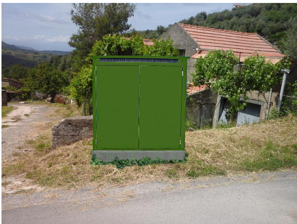
Campora – Posizione Gruppo di Riduzione – GRF Dopo
