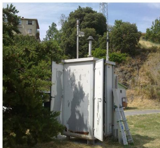
Figura 4-88 Rete Regionale di monitoraggio Stazione di Montecerboli (Pi)
