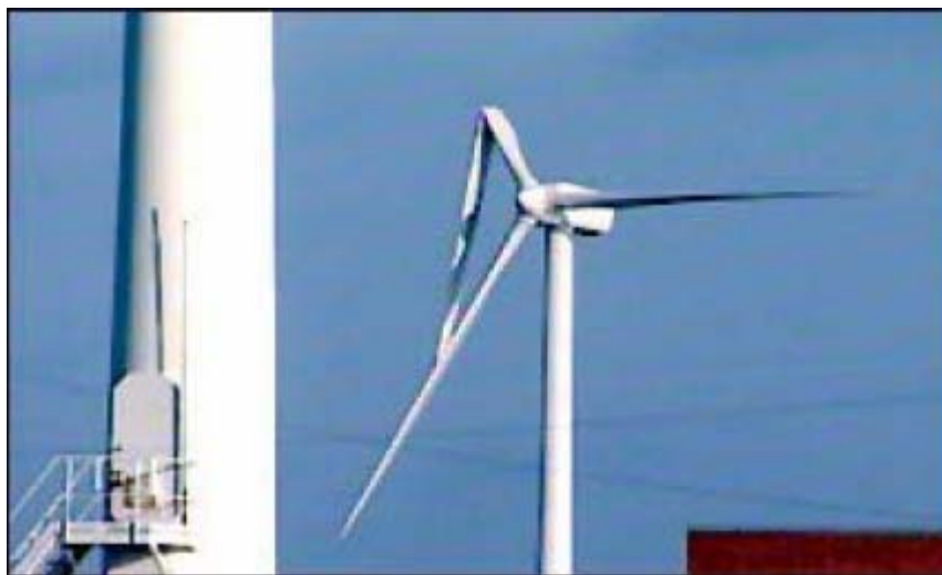
Figura 3 Esempio di rottura di pala senza distacco.
