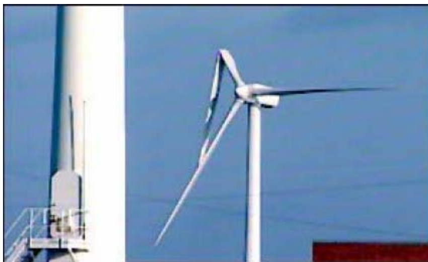
Esempio di rottura di pala senza distacco.
