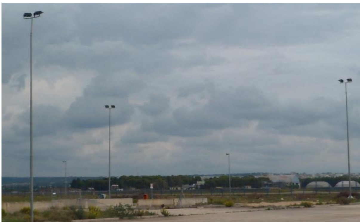
Figura 5 – Proiettori per l'illuminazione degli edifici e delle aree limitrofe
