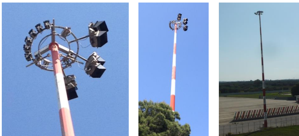
Figura 3 – Torri faro esistenti
