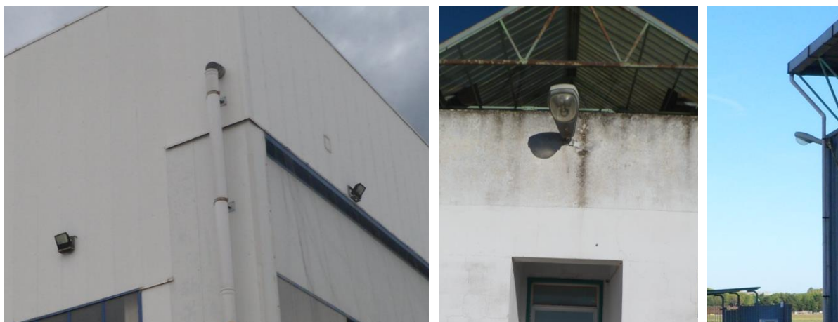
Figura 6 – Proiettori per l'illuminazione degli edifici
