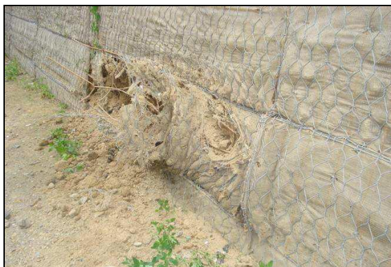
Figura 7. Svuotamento del riempimento vegetale dovuto ad un urto sul paramento
