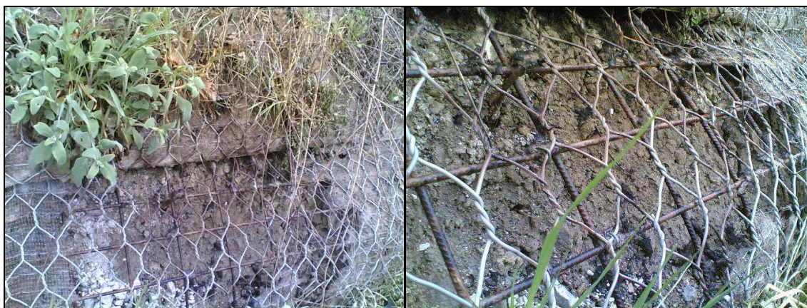
Figura 8. Perdita di materiale fine a causa di incendio e conseguente danneggiamento del ritentore di fine. Il terreno vegetale dietro al paramento rimane esposto.
