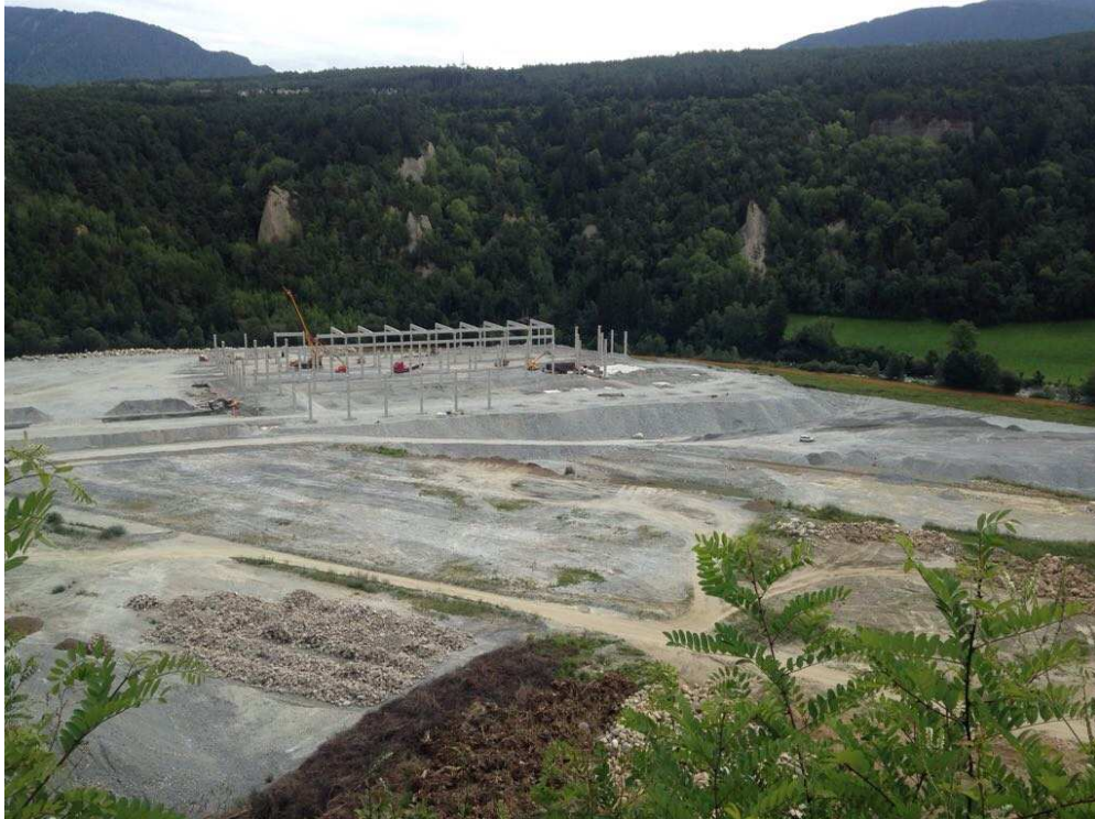
Foto del deposito polmone di Hinterrigger – situazione attuale.
