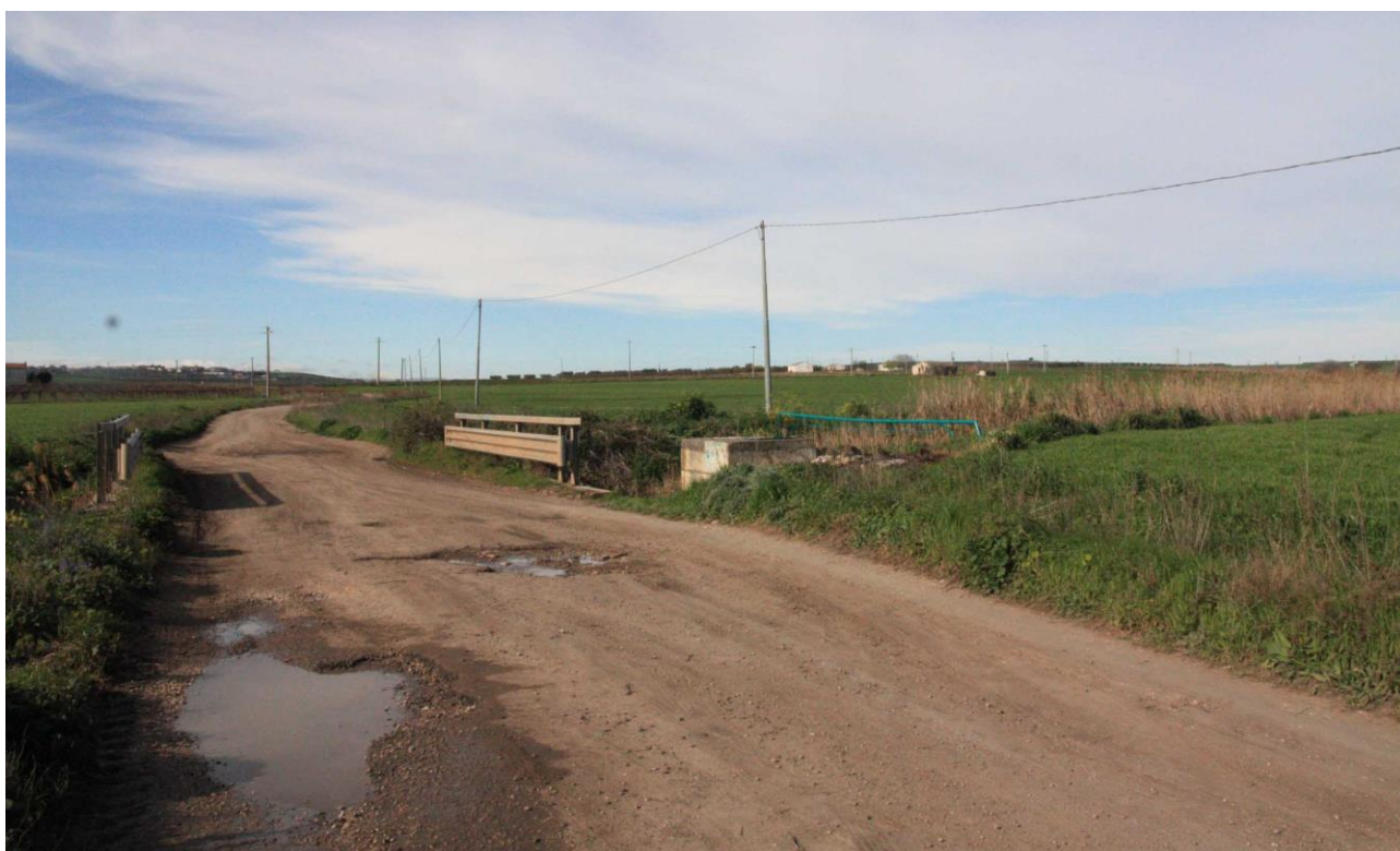
Foto 7. Strada Vicinale Titolone nella zona dalla quale dovrebbe partire il nuovo tratto di strada di progetto che dovrebbe condurre all'Aerogeneratore A5. Anche qui è evidente lo stato di dissesto in cui versa la strada. E' presente inoltre un ponte su un canale del Consorzio della Bonifica della Capitanata non idoneo al transito di mezzi di peso maggiore di 30 t
