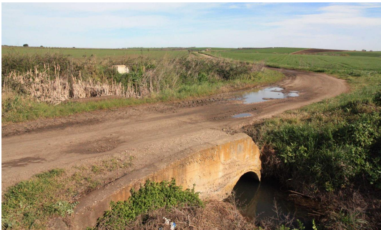
Foto 9. Strada Vicinale Titolone in corrispondenza del ponte sul torrente Carapelle, nei pressi della zona dalla quale dovrebbe partire la pista di progetto che dovrebbe condurre all'Aerogeneratore A7. Costante è lo stato di dissesto in cui versa la strada le cui caratteristiche e quelle del ponte qui rappresentato non consentono di fatto il transito di mezzi con Trasporto Eccezionale fino a 100 t.
