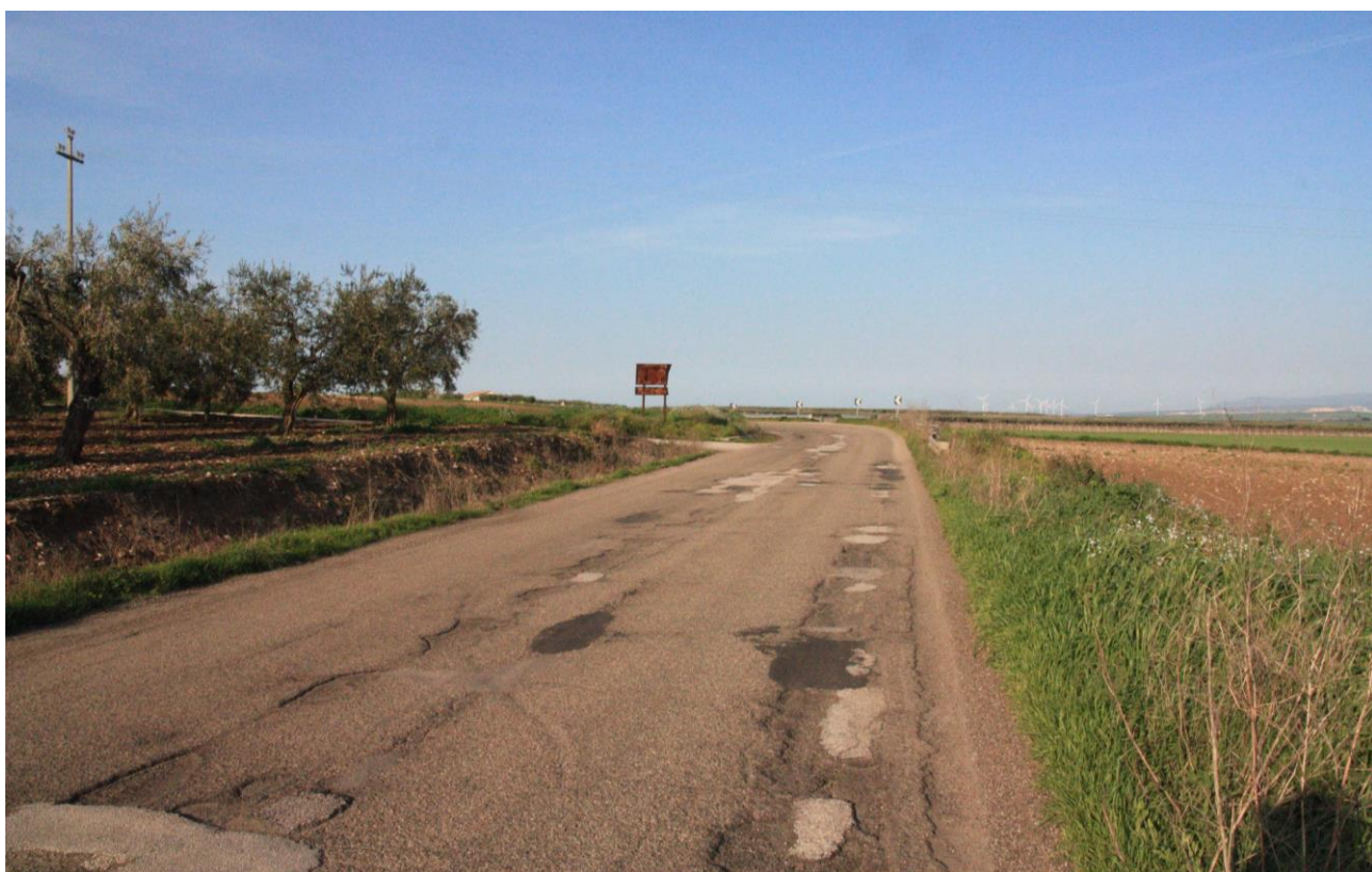
Foto 3. Strada Provinciale 31 San Paolo di C. – Ripalta, nello stato attuale. In fondo sulla sinistra, prima della curva, si scorge l'intersezione con la strada interpodereale che dovrebbe condurre agli aerogeneratori A1 e A2. La S.P. 31 non presenta caratteristiche idonee al trasporto eccezionale fino a 100 tonn. per la realizzazione del Parco Eolico di progetto.
