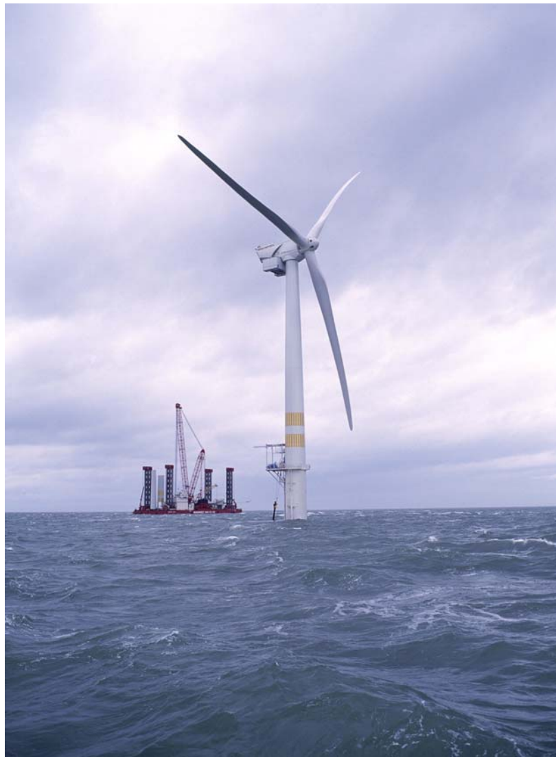
Figura 3.3: Turbina eolica da 3,6 MW installata in mare.
