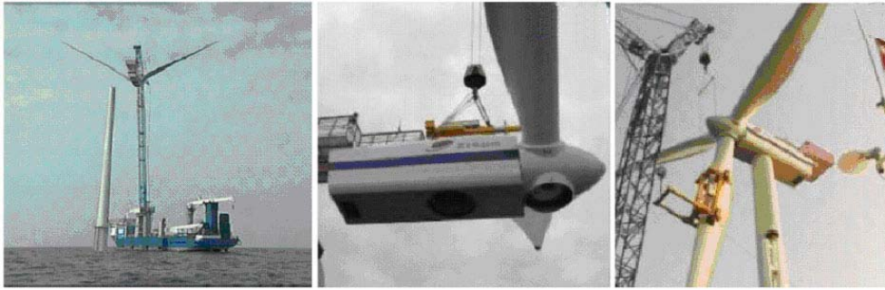
Figura 3.22: Installazione della turbina con il metodo bunny ear, nel progetto di Horns Rev.
