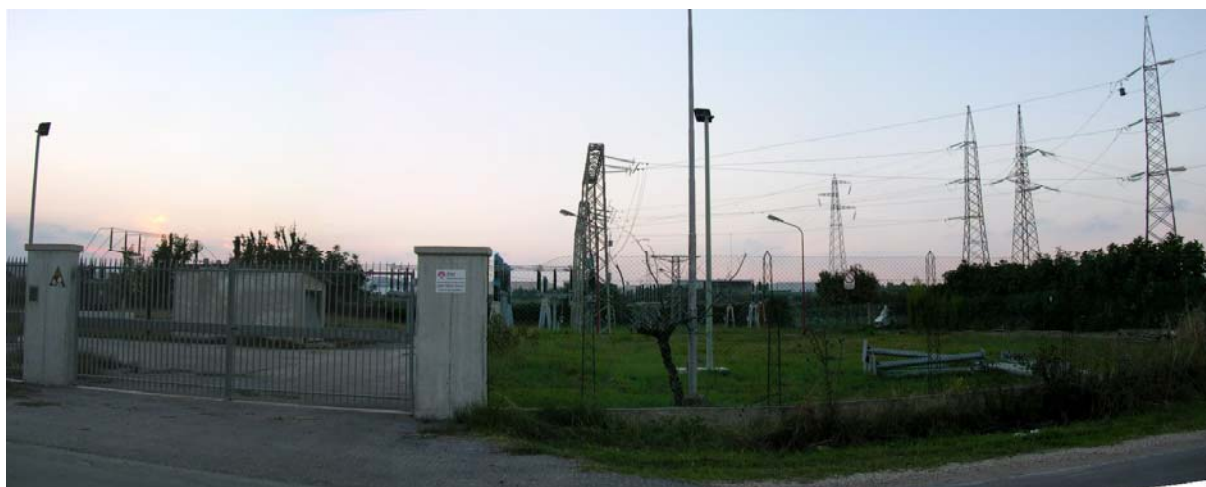
Figura 3.8: Stazione di smistamento di S. Salvo, cabina primaria 150/20 kV.
