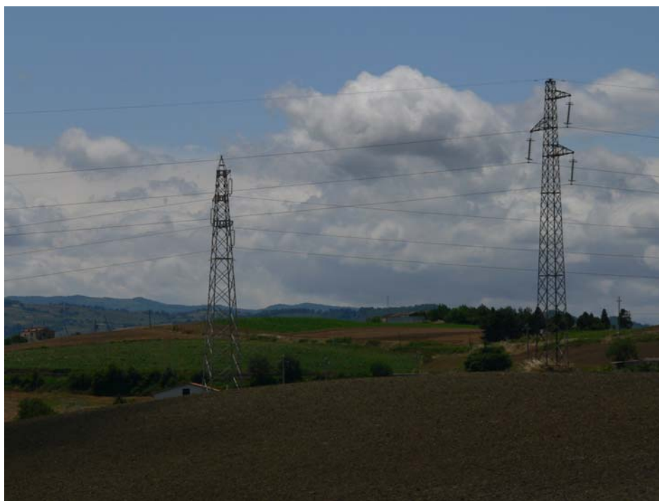
Figura 4.15: Tralicci della linea di collegamento alla stazione di S. Salvo, foto scattata dal punto P-12 in direzione WSW
