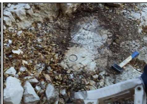
Particolare 2 - rottua della roccia su perno
