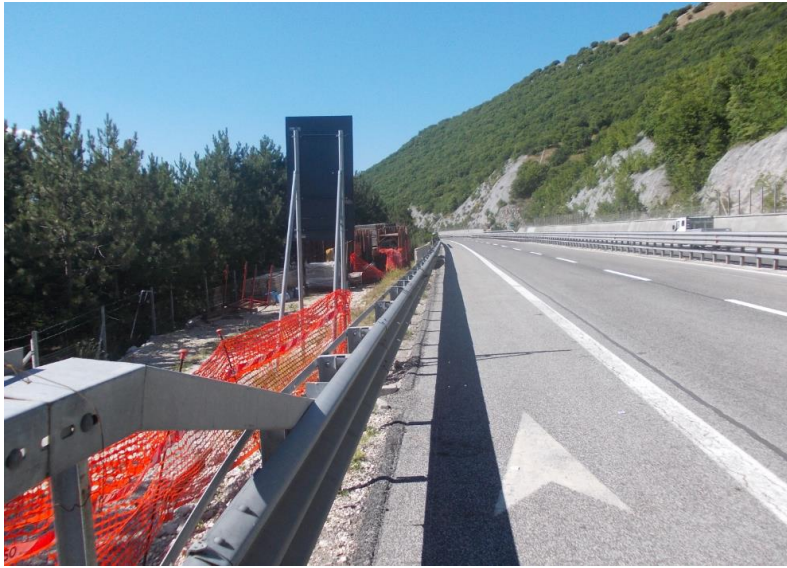
Figura 6: Foto dell'area di posizionamento dell'impianto di trattamento.
