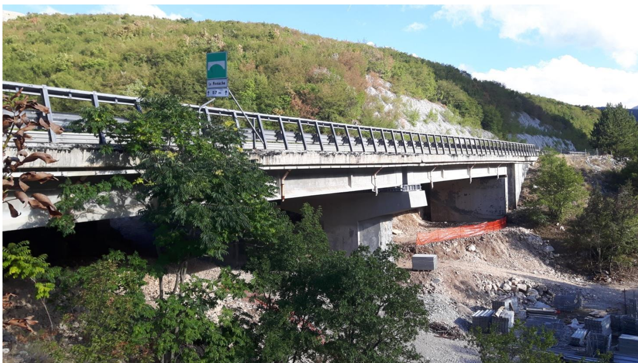
Figura 2: Attuale sistema di scarico delle acque di piattaforma del Viadotto Le Monache.
