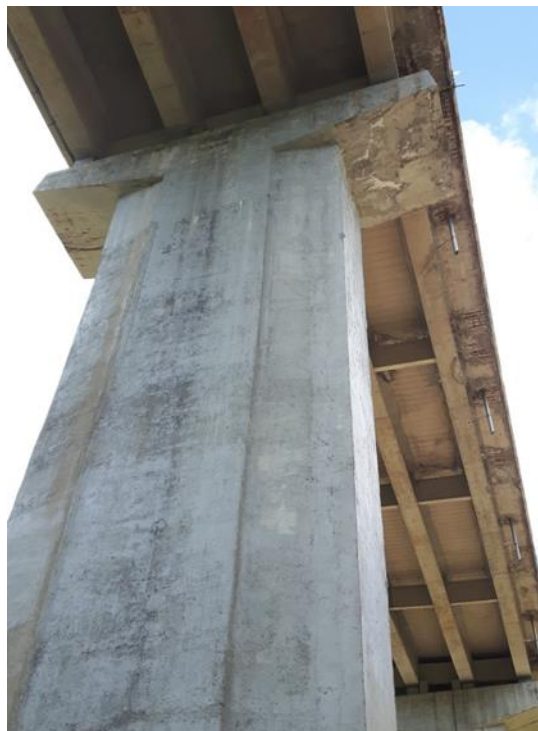
Figura 7 – Pila viadotti e stato di ammaloramento
