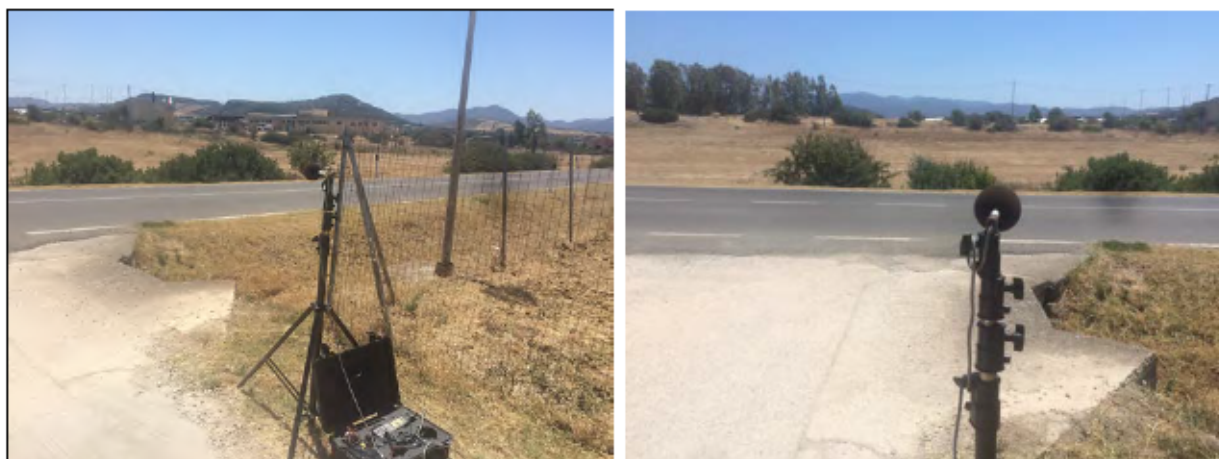
Figura 3 Installazione postazione fonometrica PS1-A sulla SS 293 tratto Giba-Piscinas
