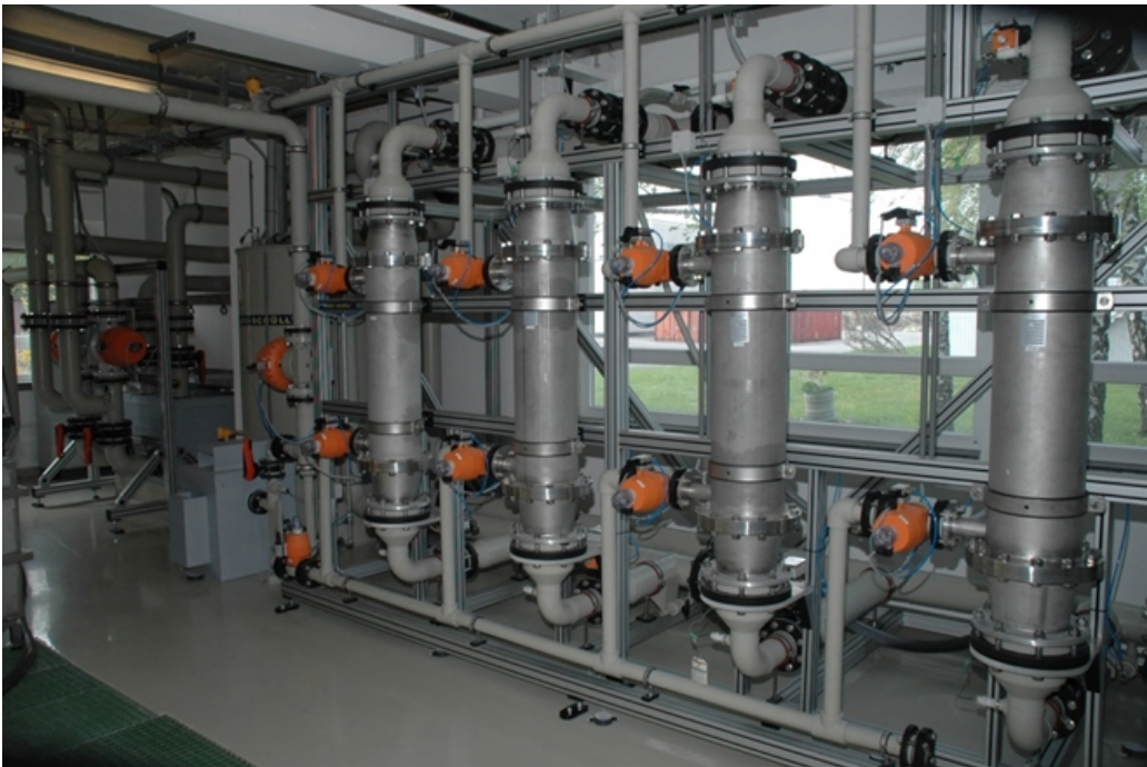
Abbildung 6: Filtriereinheit der Ultrafiltrationsanlage
