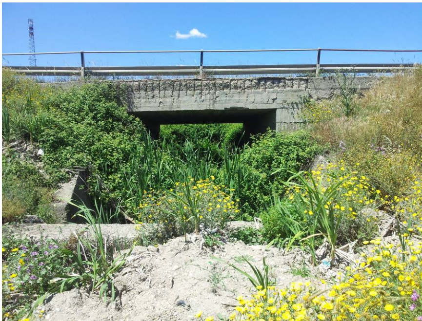
Foto 2 – Tombino esistente alla confluenza fra I3bis e I5 in I4
