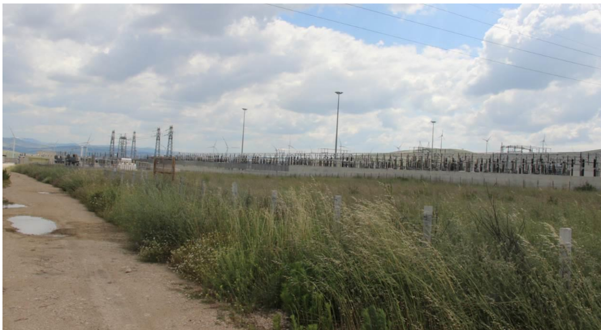
Figura 11 – Stazione RTN 380 kV “Deliceto” di proprietà Terna
