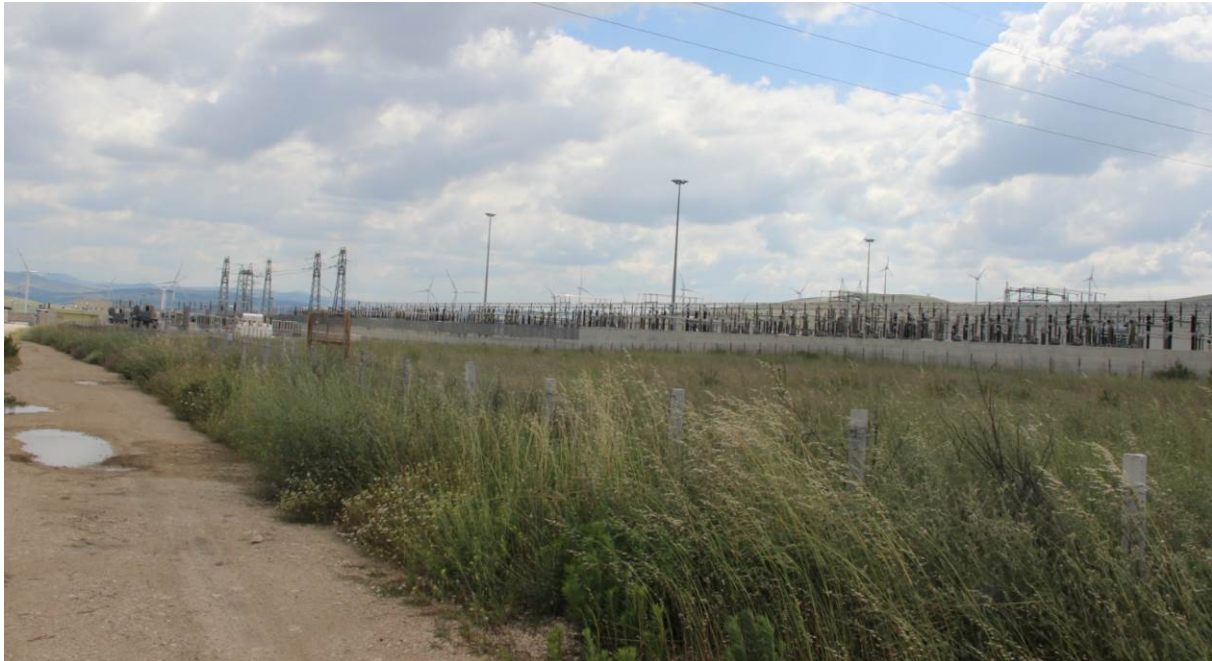
Figura 7 – Stazione RTN 380 kV “Deliceto” di proprietà Terna
