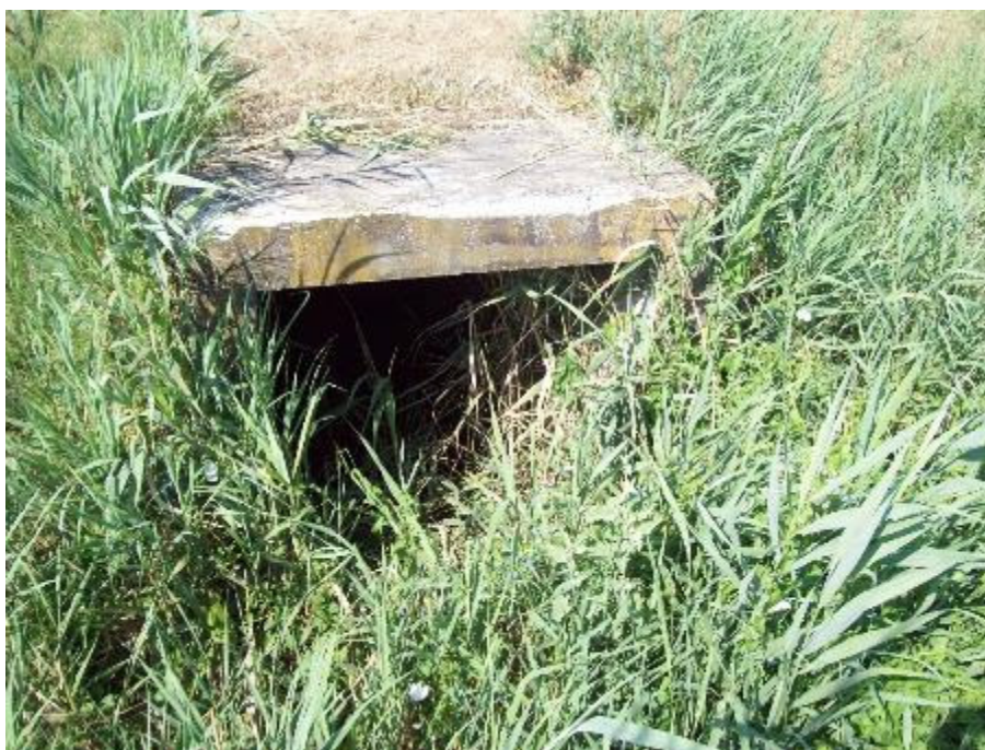
Figura 6-10. Scolo Fossa Barchetta in corrispondenza dello scatolare autostradale
