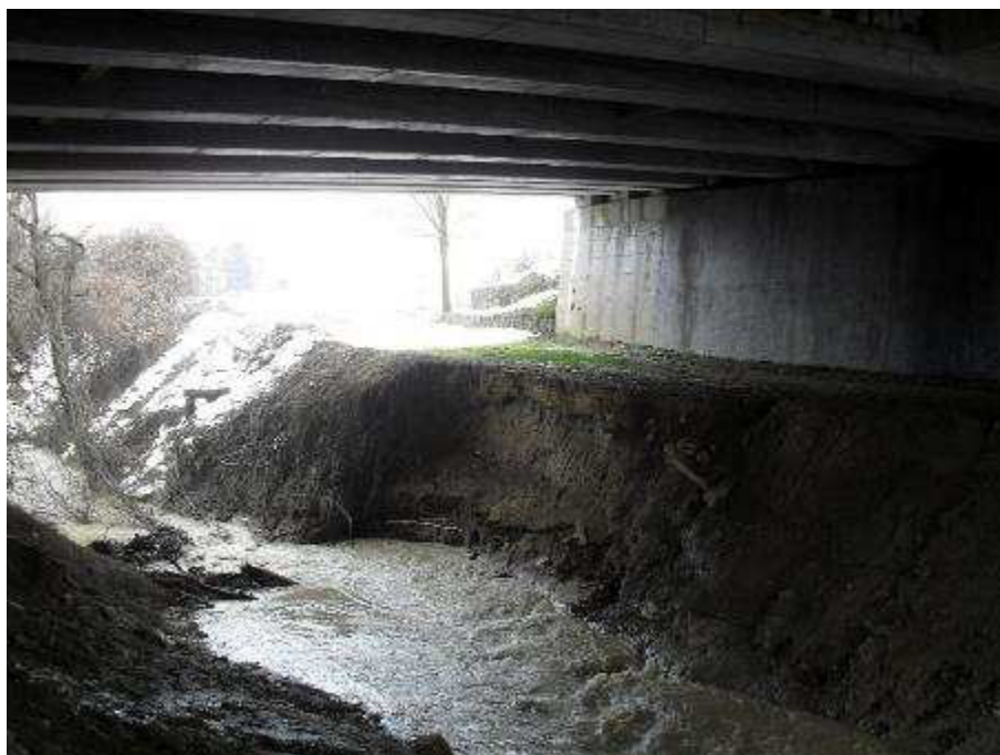
Figura 5-50. Erosione spondale del rio Sanguinario lungo la luce del ponte autostradale
