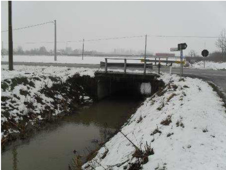
Figura 5-1. Rio Rosso in corrispondenza dello scatolare sulla strada provinciale Colunga a valle dell'A14
