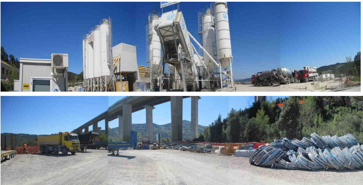
Figura 10 – Panoramiche SF 04 – Campo operativo/ centrale di betonaggio (in alto) – area sotto viadotto (in basso)
