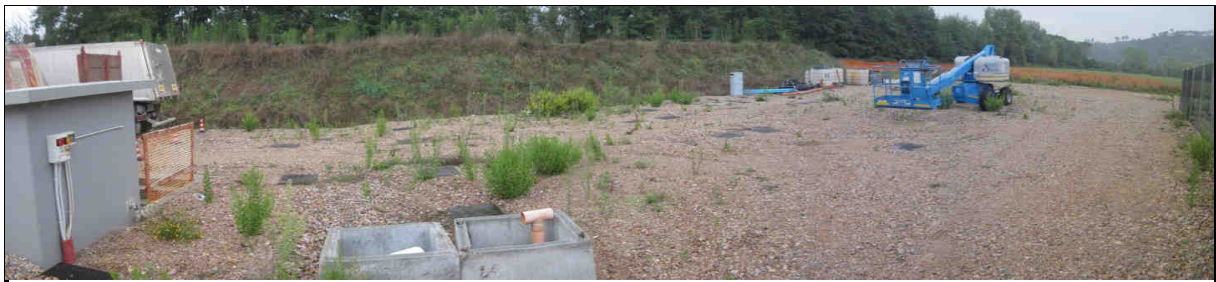
impianto trattamento acque
