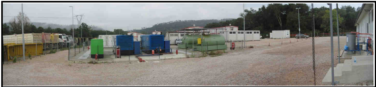
zona generatori / carburanti
