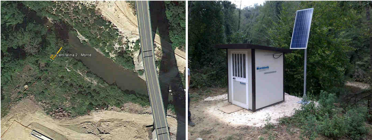
Figura 41 – Centralina 2 – Monte ed indicazione del cavidotto di indagine (43° 4'38.75"N - 11°17'44.29"E)
