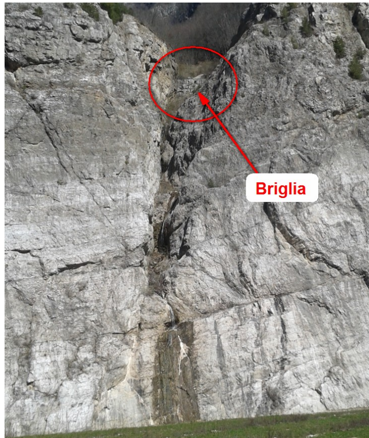
Figura 4 – Svincolo di Pedemonte. Briglia di contenimento in corrispondenza della forra che incide le pareti calcareo-dolomitiche sovrastanti l’area di svincolo di Pedemonte
