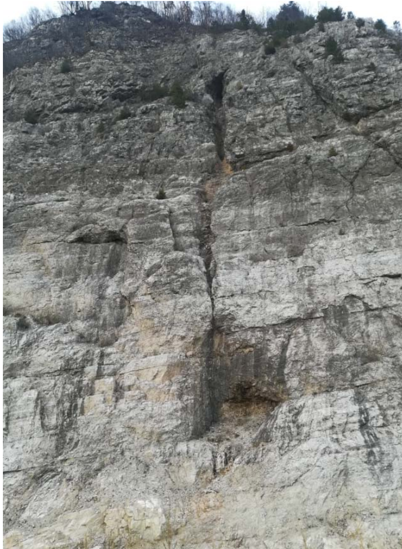
Figura 6 – Parete sovrastante il settore di svincolo con potenziali distacchi soprattutto dal settore medio superiore del fronte
