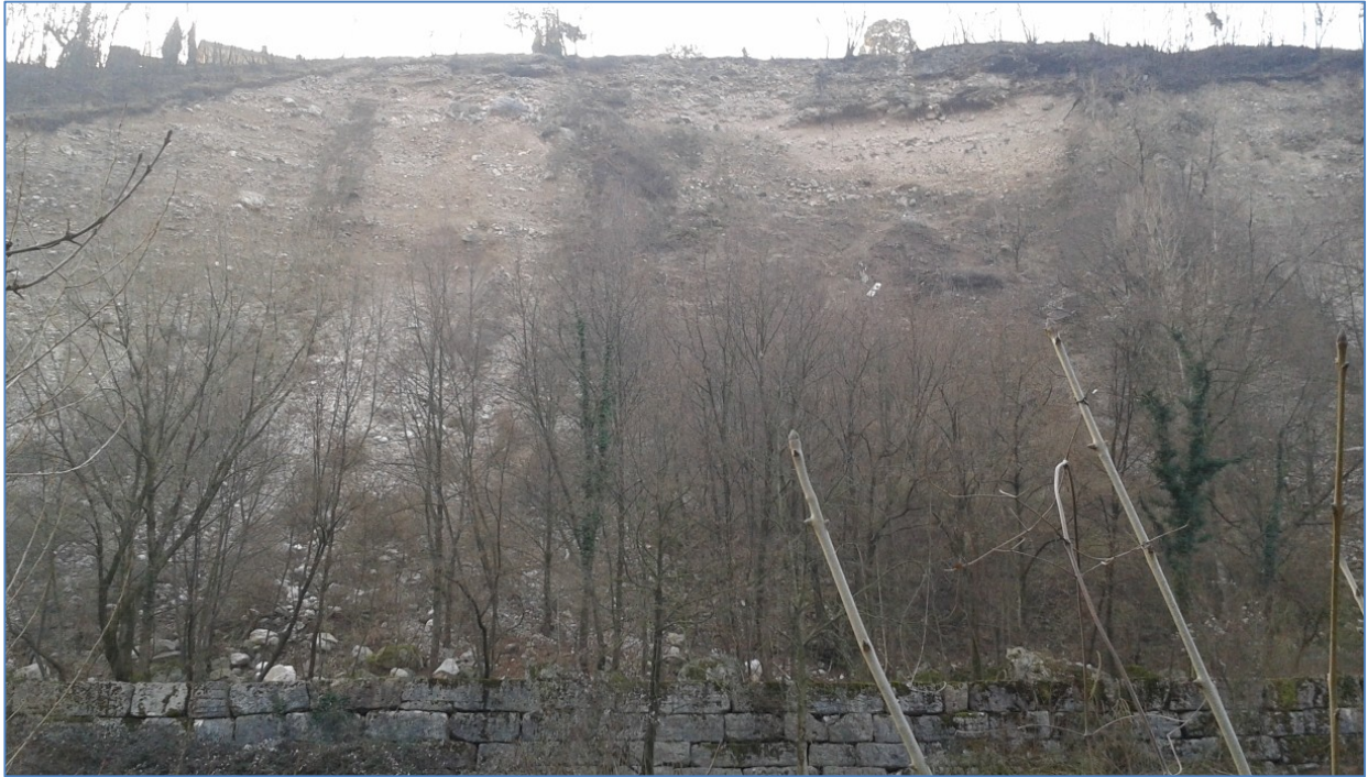
Foto 2 Frana in destra Astico a margine del viadotto Piovene. La fotografia permette di osservare la stratigrafia dei depositi fluvioglaciali inglobanti ciottoli, massi e orizzonti ben cementati. In sommità orizzonti di materiale ben cementato; al piede un muro di protezione
