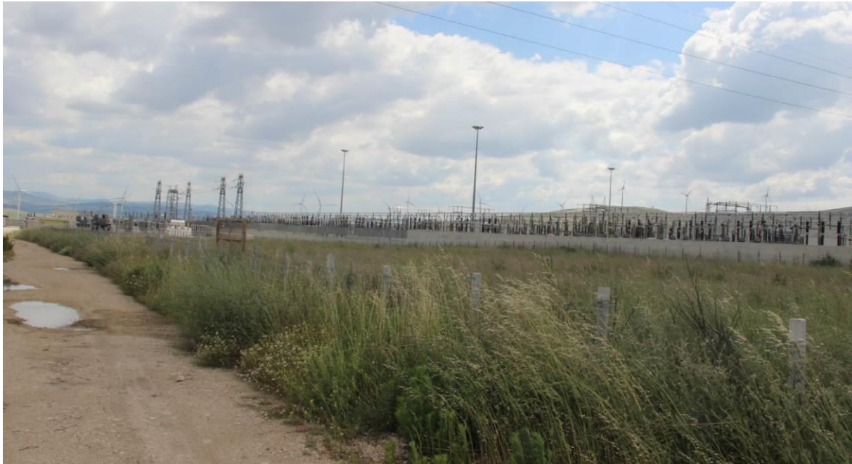
Figura 7 – Stazione RTN 380 kV “Deliceto” di proprietà Terna
