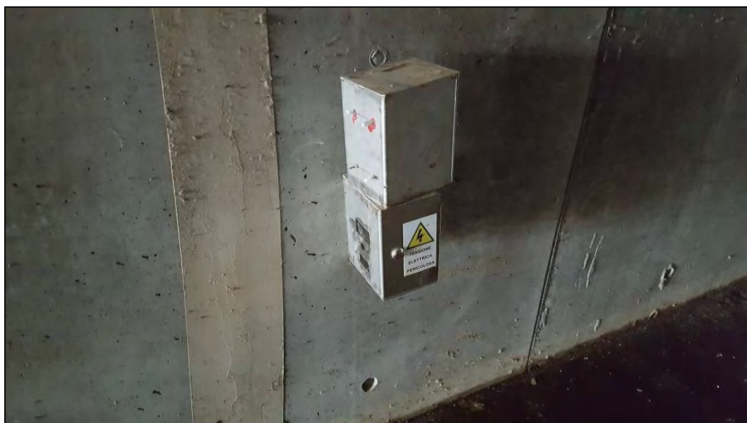
Figura 5.7.14 – Cassetta divelta e posizionata sopra alla vicina AV-RI07-FA7-06-Sud
