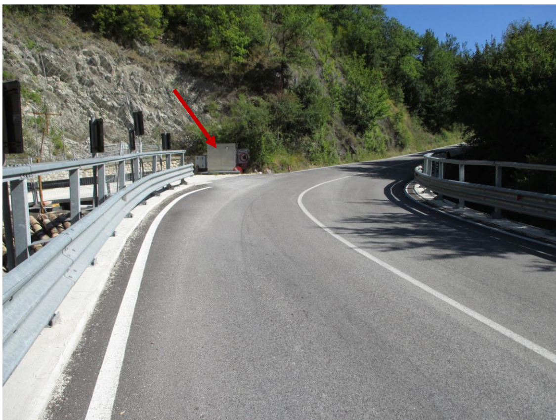
Figura 17 – Cabina di decompressione del gas metano a servizio del Centro Termale.
