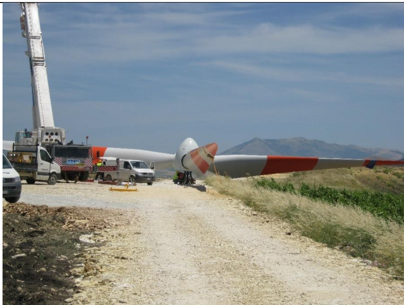
Particolare del supporto in acciaio su cui è collocato il rotore
