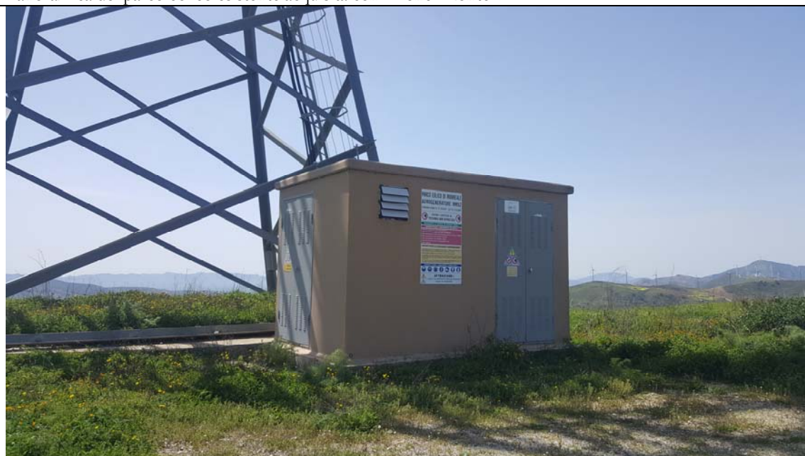
Cabina prefabbricata posta ai piedi di ciascun aerogeneratore – fonte HE
