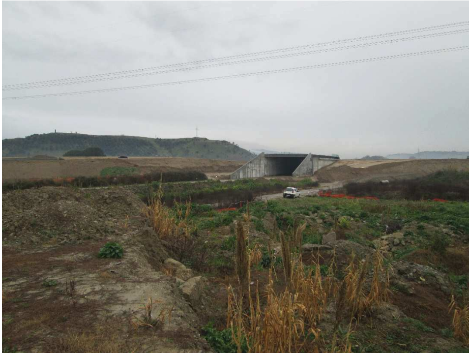
Vista 7 – Sottovia di nuova realizzazione presso lo Svincolo di Torre Mordillo e rilevato del corpo stradale in fase di realizzazione
