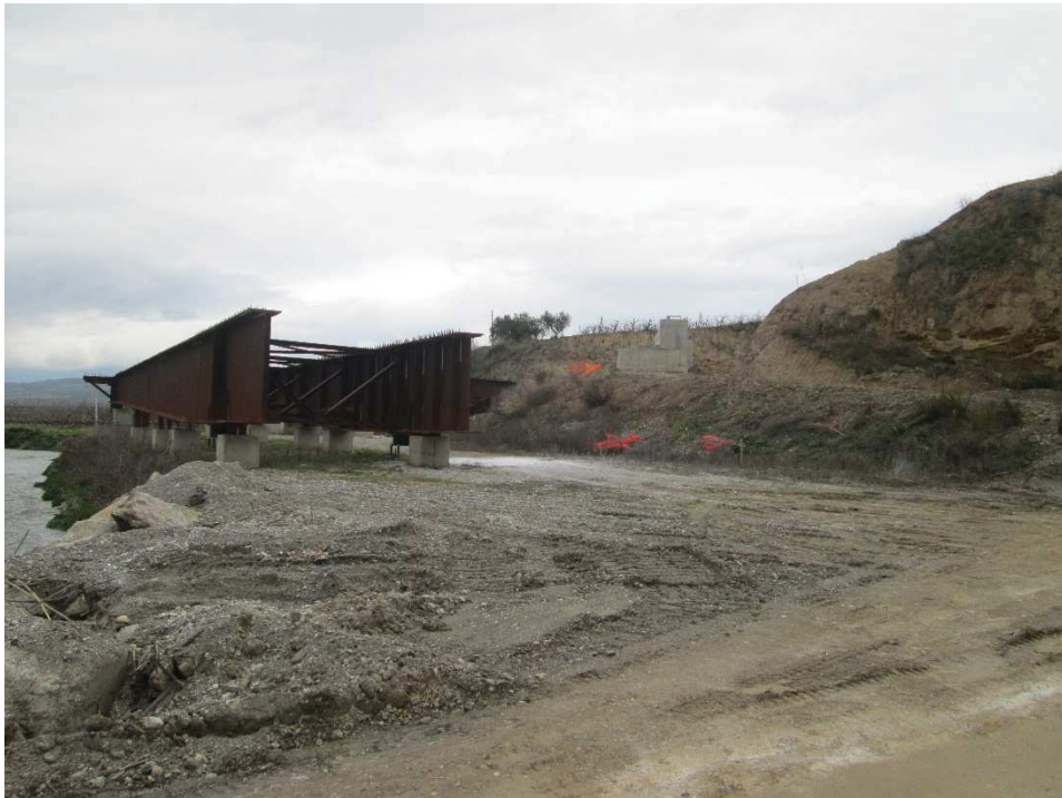
Vista 2 – Zona golenale sulla sinistra idraulica del Fiume Coscile. L'area si presenta cantierizzata, con parte dell'impalcato del viadotto in attesa di varo. Sullo sfondo si osserva la spalla lato Sibari della carreggiata in direzione Firmo.
