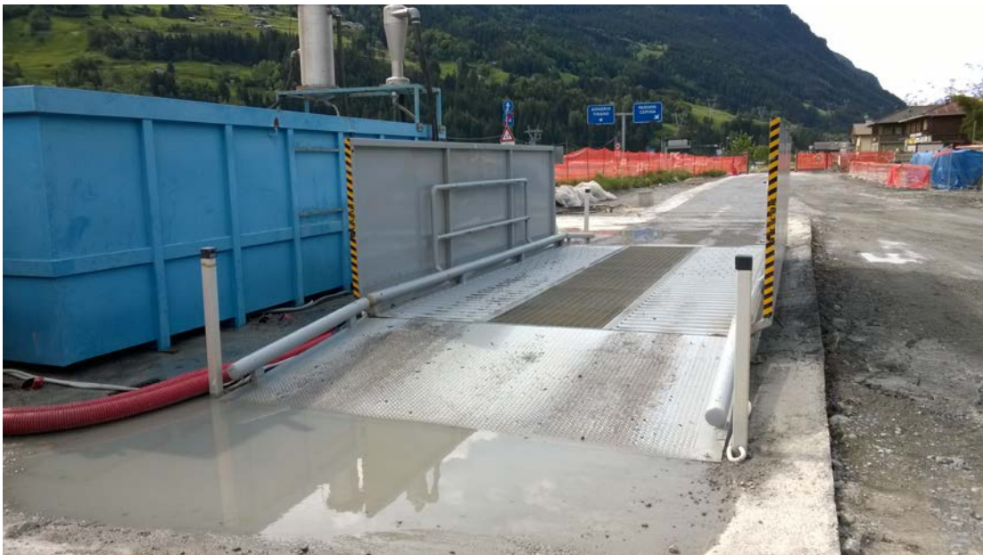
Figura 13: Impianto per lavaggio ruote
