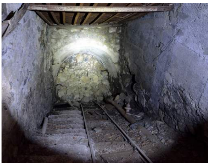
Galleria con ingresso ostruito da detriti.
