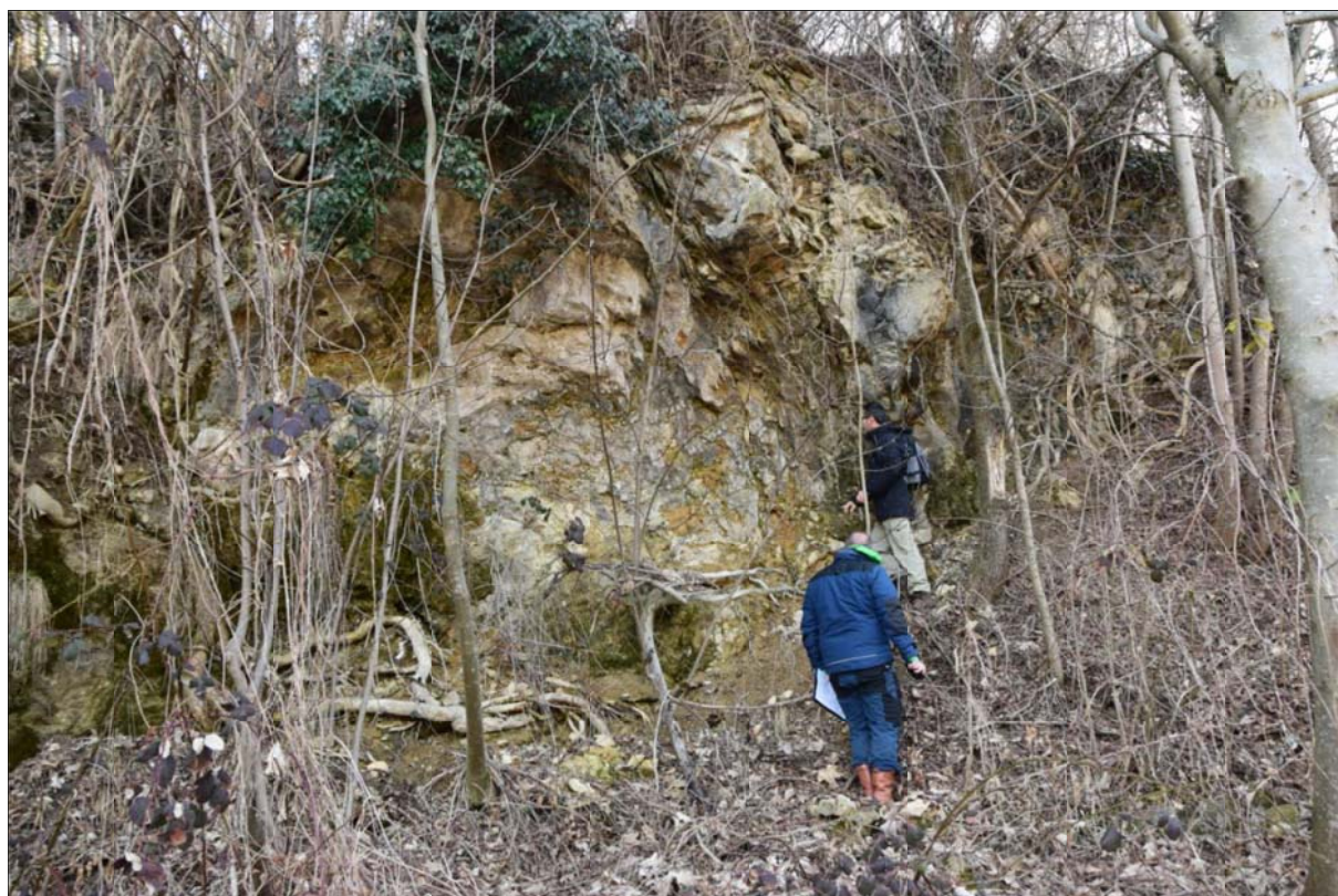
Figura 7- Affioramento di Calcari Giurassici in cui è presente il piano di faglia F1
