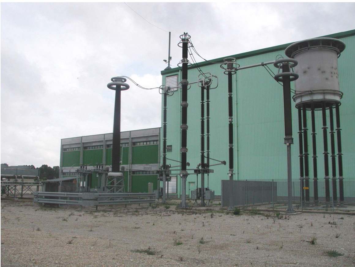
Foto 13 Montante AT 400 kVcc
