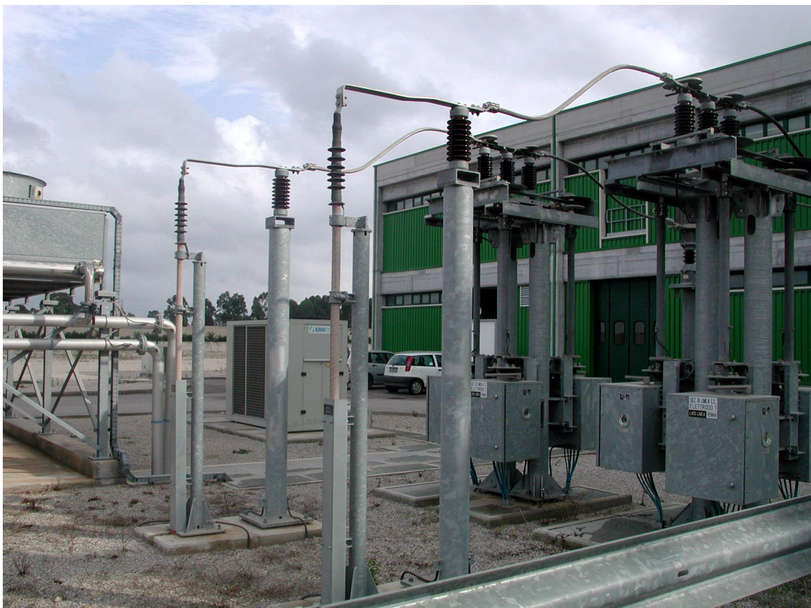
Foto 17 Montante AT 400 kVcc: particolare dei terminali di ritorno MT del cavo terrestre
