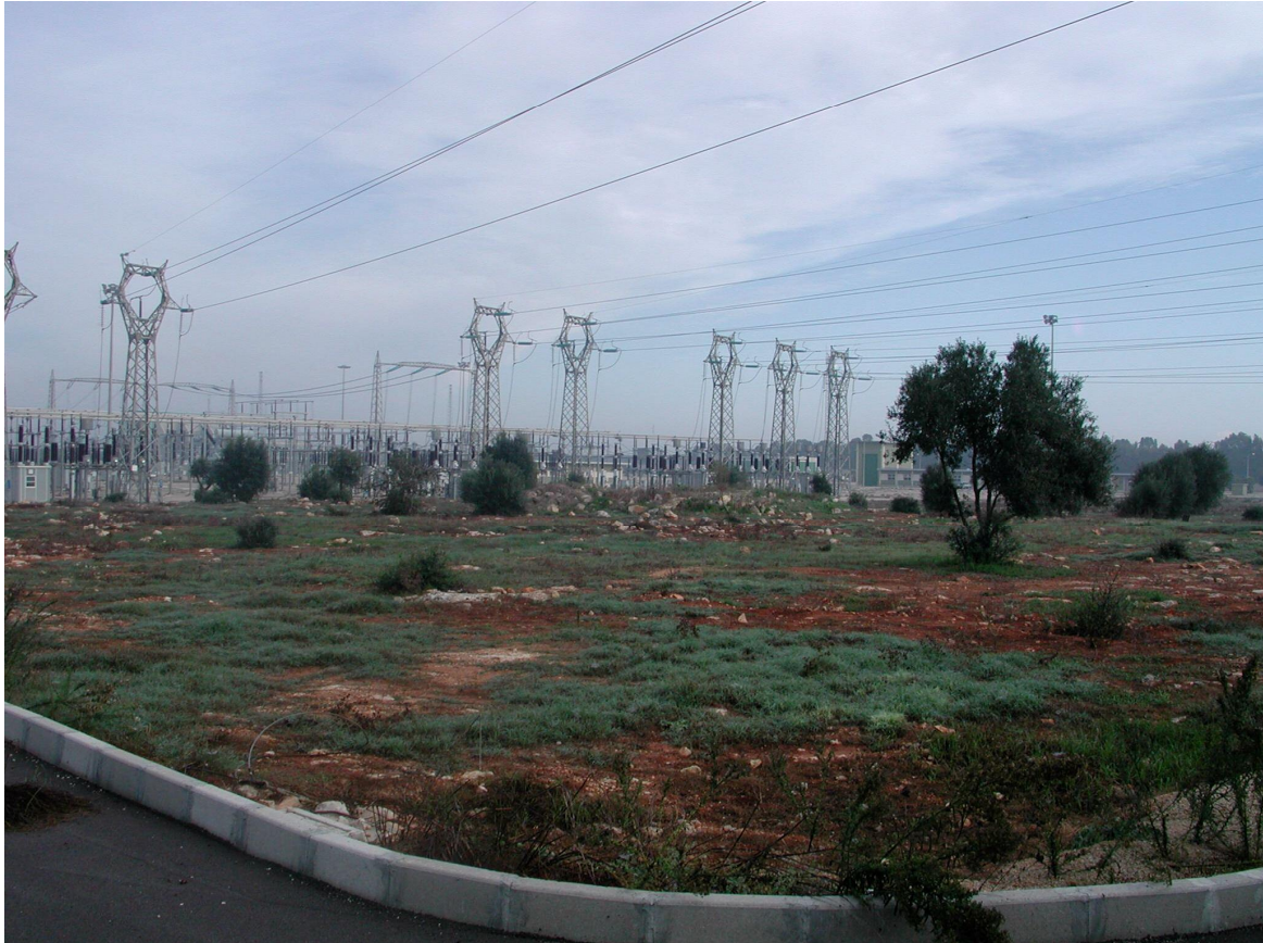
Foto 2 Stazione di trasformazione
