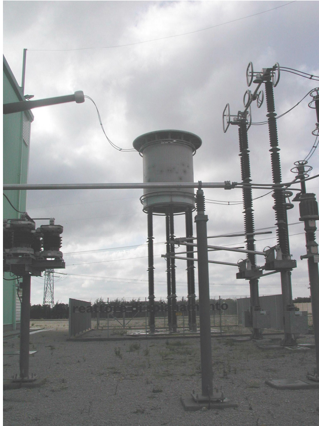
Foto 14 Montante AT 400 kVcc: sullo sfondo, il reattore di spianamento
