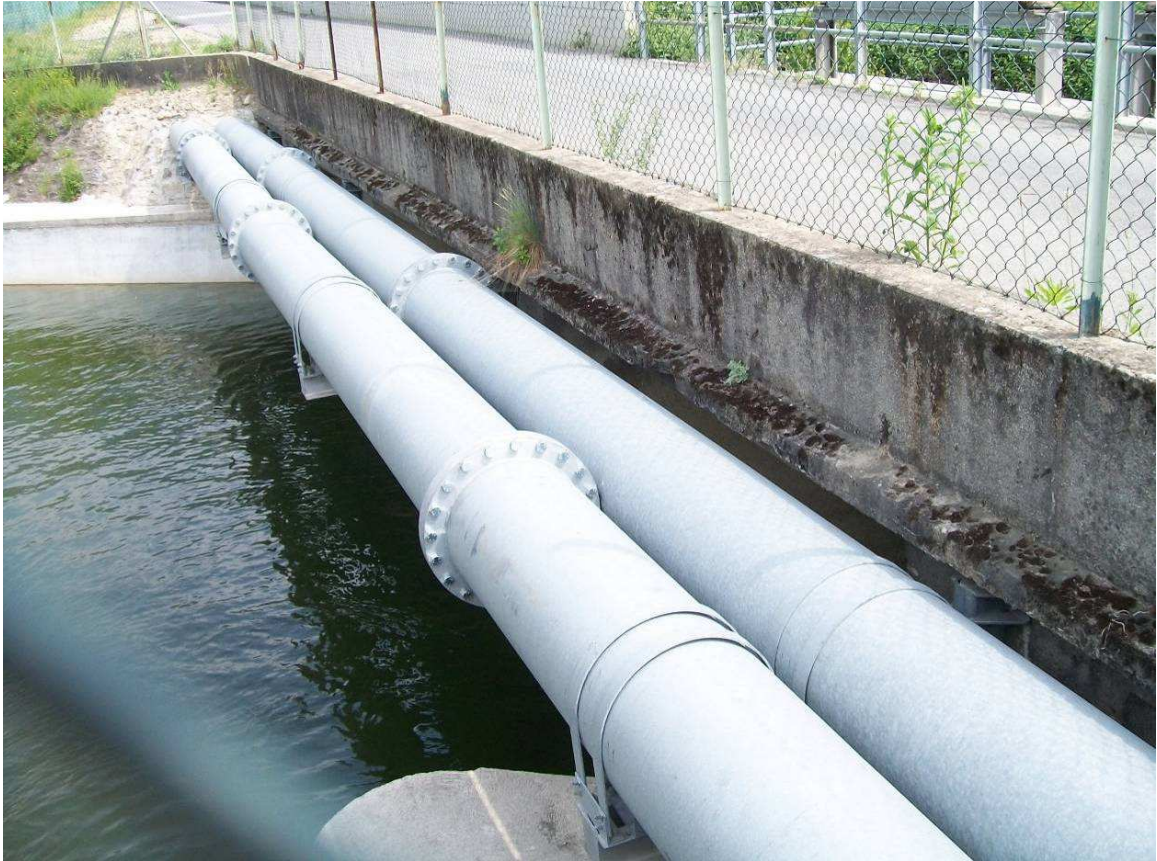
Esempio di ancoraggio di tipo "tubiera". Si noti come in questo caso gli elettrodotti ancorati siano due.
