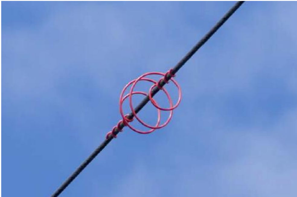
Figura 3.9: Spirale colorata in plastica per la segnalazione dei cavi
