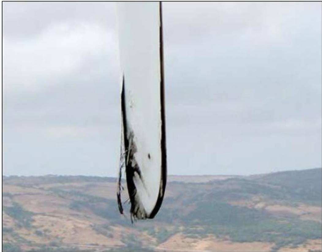
Estremità della pala danneggiata da fulminazione atmosferica
