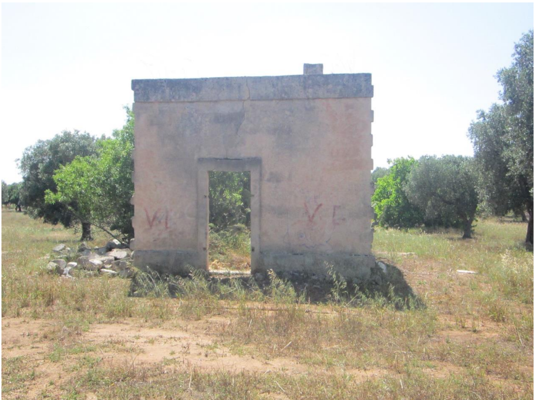
Manufatto N – Deposito attrezzi agricoli privo di finestre diroccato
