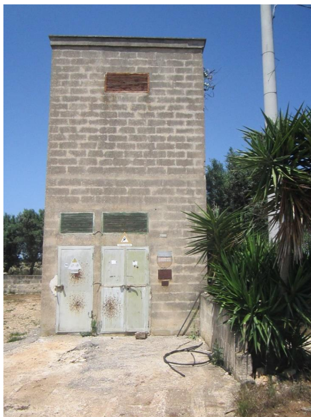
Manufatto A - Cabina elettrica MT/BT di tipo alto
