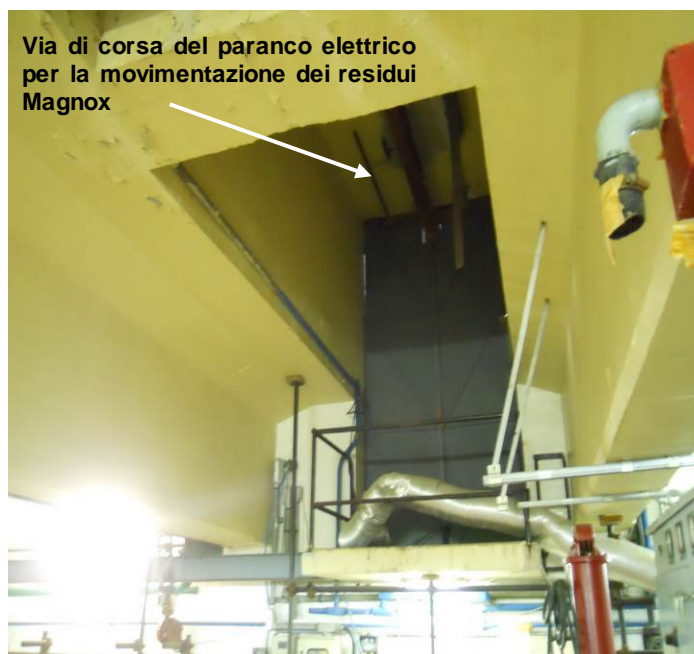
Figura 12: Portale di comunicazione tra Edificio Pond ed Edificio Fosse Splitters.
