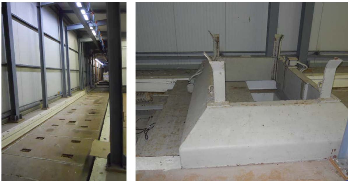
Figura 13: “Dalle” di copertura delle Fosse Splitters e paranco elettrico di servizio (a sinistra). Particolare del sistema di chiusura delle botole, a schermo mobile.
