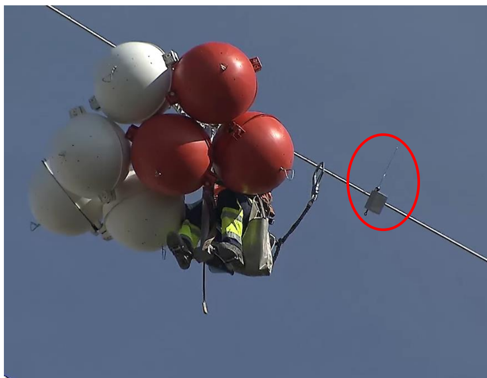
Installazione del BSI (cerchio rosso) – veduta dal basso
