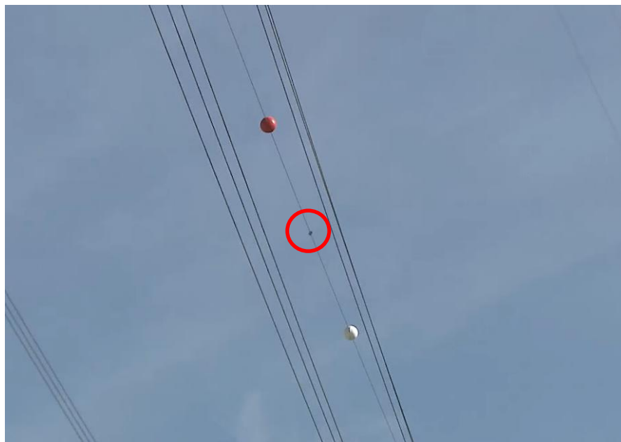
Installazione del BSI (cerchio rosso) – veduta dal basso
