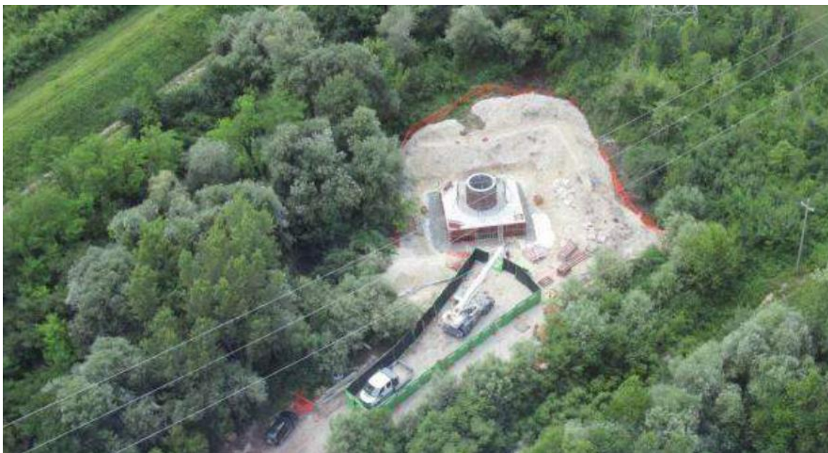
Tratta 3: Sostegno P54 (si noti la recinzione con pannelli fonoassorbenti intorno ai mezzi operanti nel cantiere) – luglio 2017
