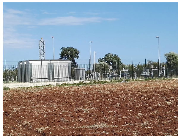
Foto 10: Vista frontale ingresso impianto esistente
