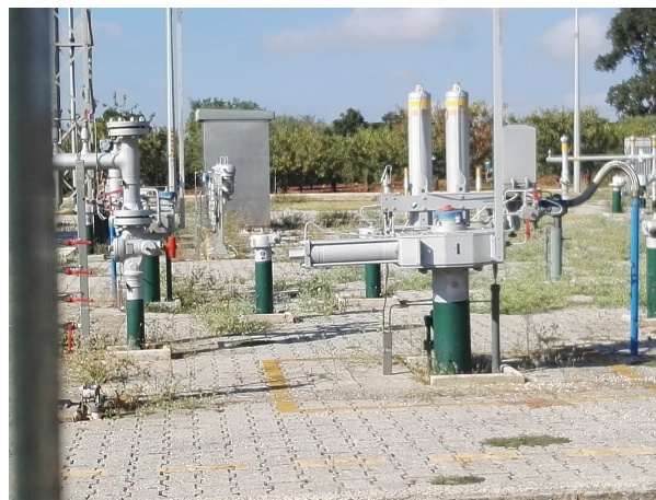
Foto 8: Vista frontale impianto di regolazione PID esistente.
