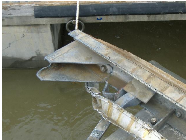
Figura n. 6 - Vista rottura ancoraggi pontili sottoflutto
