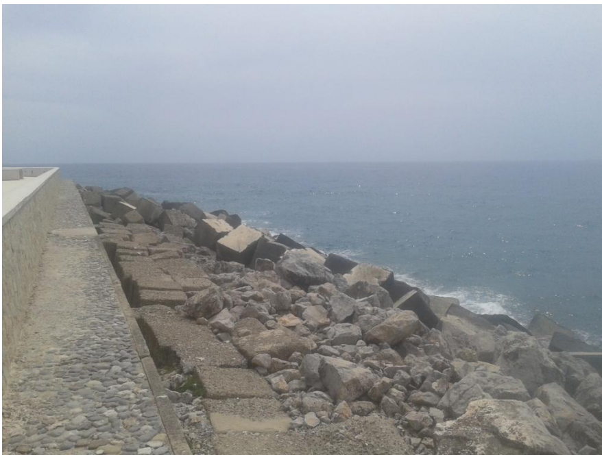
Figura n. 7 - Vista denudamento della mantellata del sopraflutto
