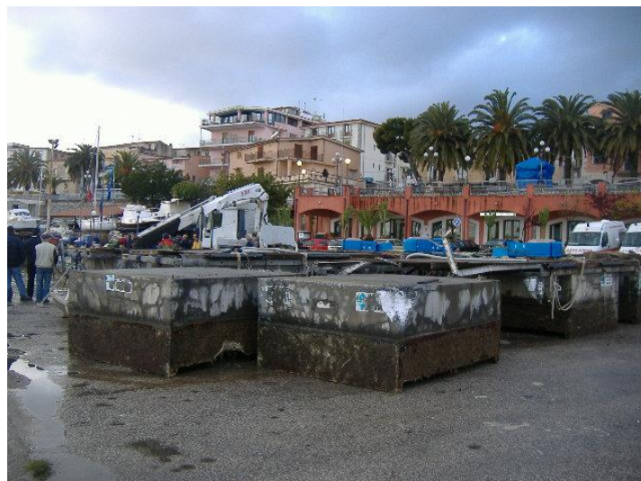
Figura n. 7 - Vista rottura dei cassoni pontili sottoflutti recuperati nel bacino
