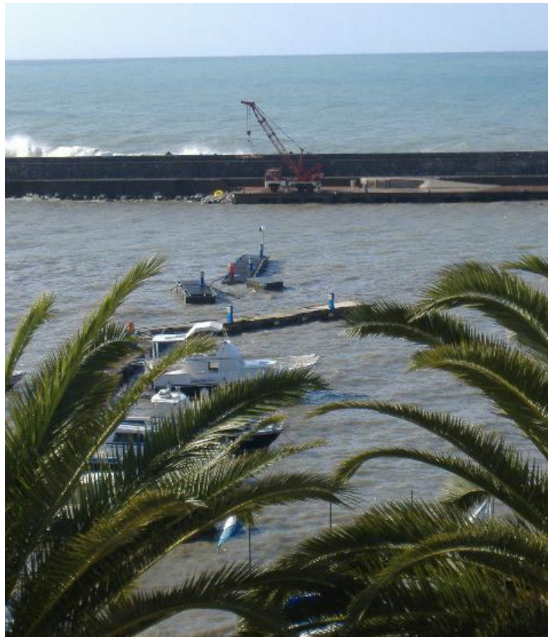
Figura n.2 - Vista della rottura dei pontili sottoflutto - agitazione del bacino interno e dell'onda frangente proveniente da libeccio
