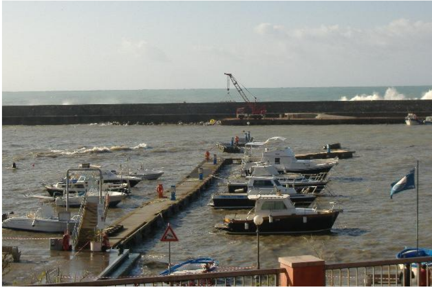
Figura n. 3 - Vista della rottura dei pontili sottoflutto - agitazione del bacino interno e dell'onda frangente proveniente da libeccio
