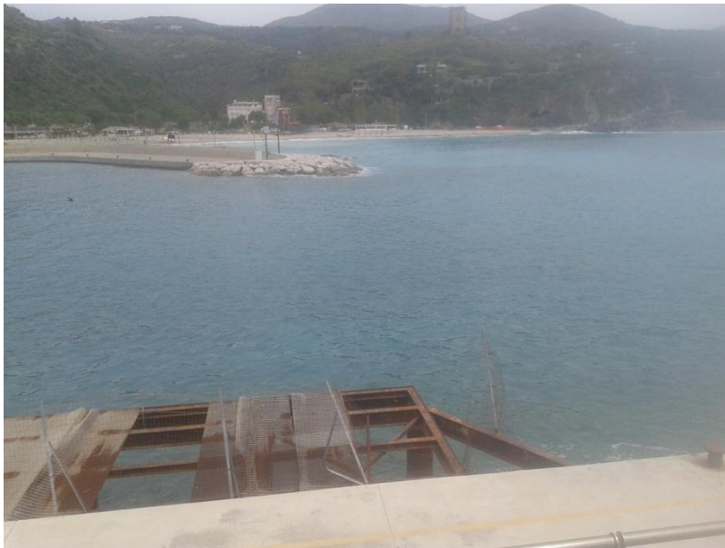
Figura n. 9 - Vista danneggiamento pontile di attracco
