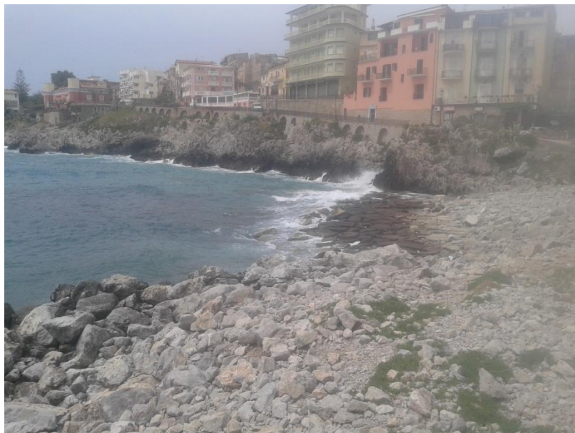
Figura n. 8 - Vista denudamento della mantellata del sopraflutto
