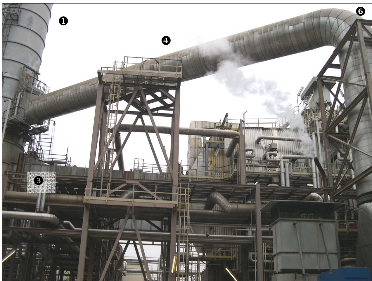
Vista d'insieme sbocco condotte su camino dell'Impianto di Cogenerazione
