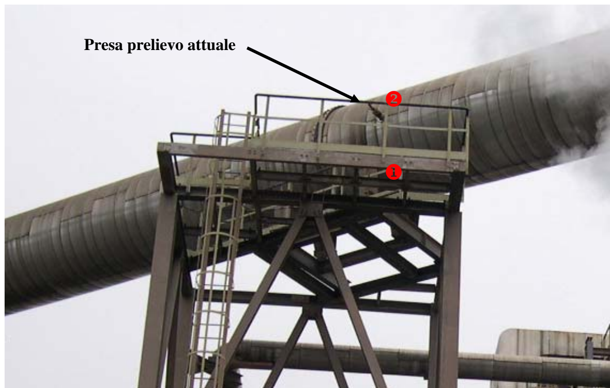
Presa di prelievo attualmente installata nel condotto relativo alla Caldaia B02
